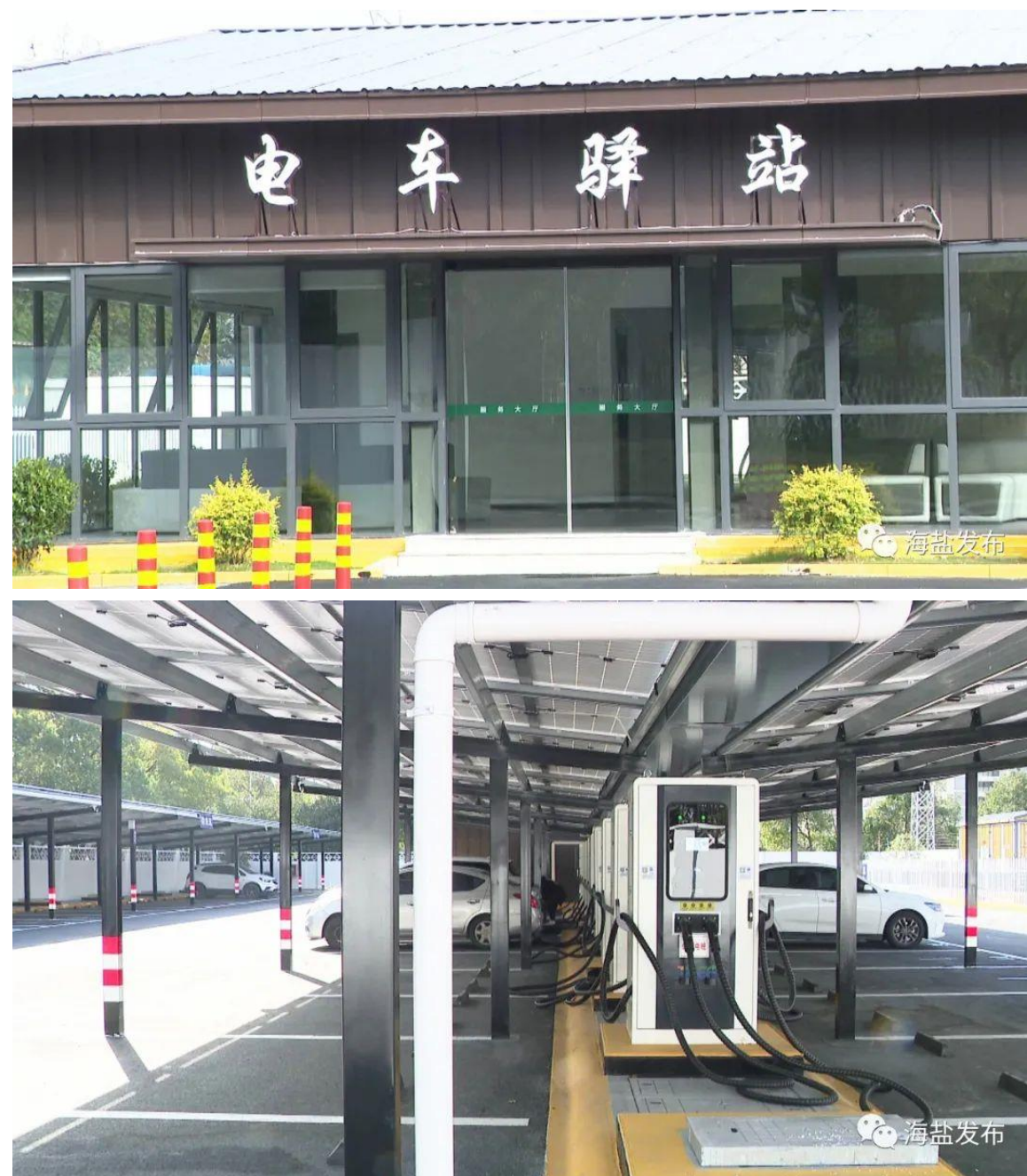
图7-2 海盐“电车驿站”多功能公共充电站
