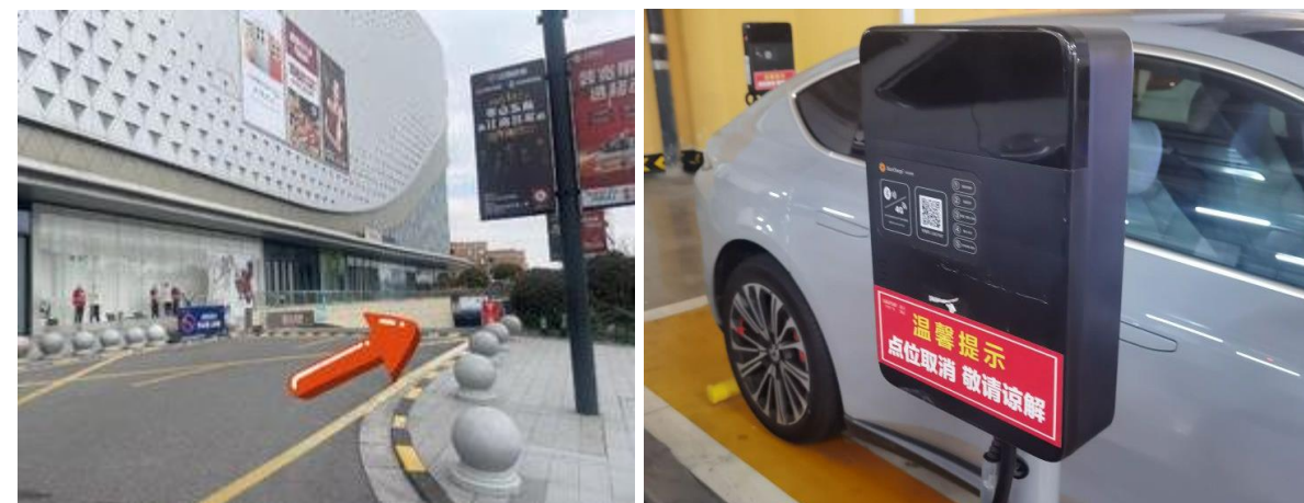
图7-1 海盐吾悦广场多功能充电站
